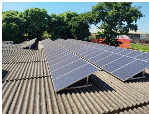
Painéis solares instalados no telhado da UPEQ.
